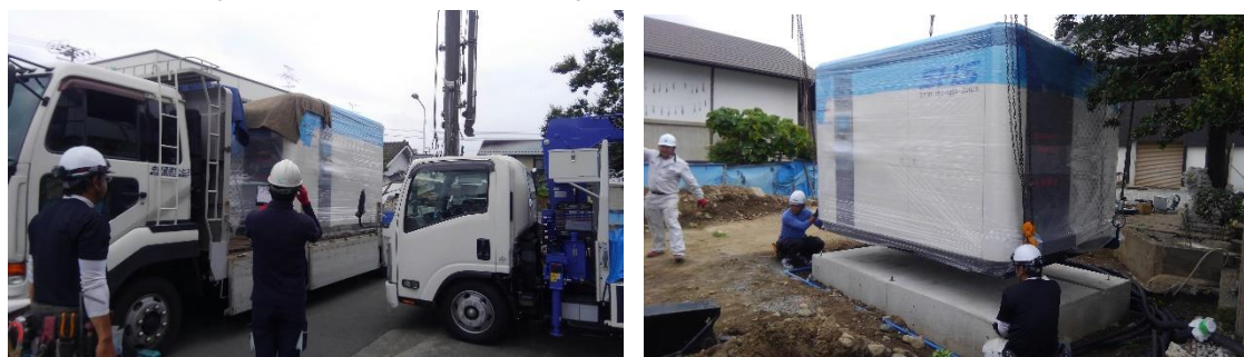
20tトラックにて運搬、クレーンを使用し土台へ設置、固定。
